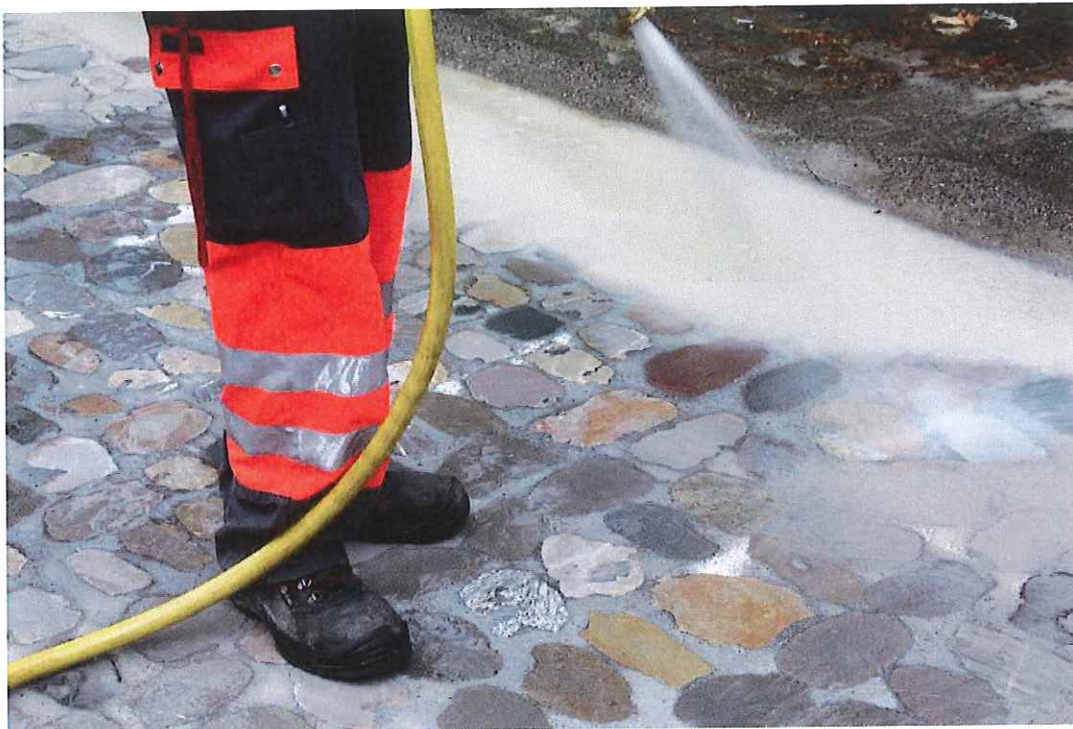
Bild 4 Pflasteroberfläche nach Abschiff
