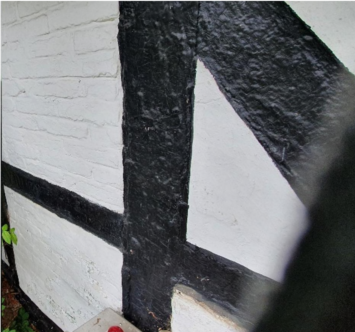
Foto 16- Zerstörtes Holz ( unter Anstrich )
