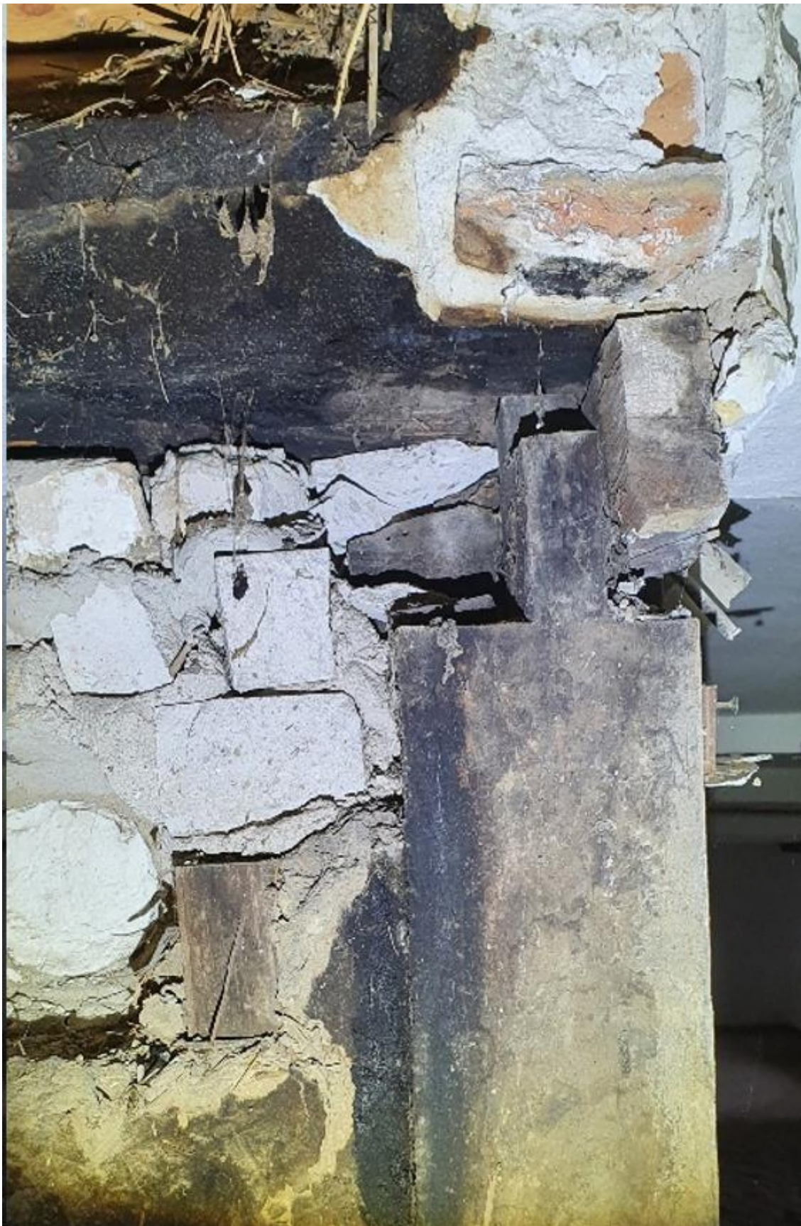
Foto 18 - ungeklärte Auflager Situation
