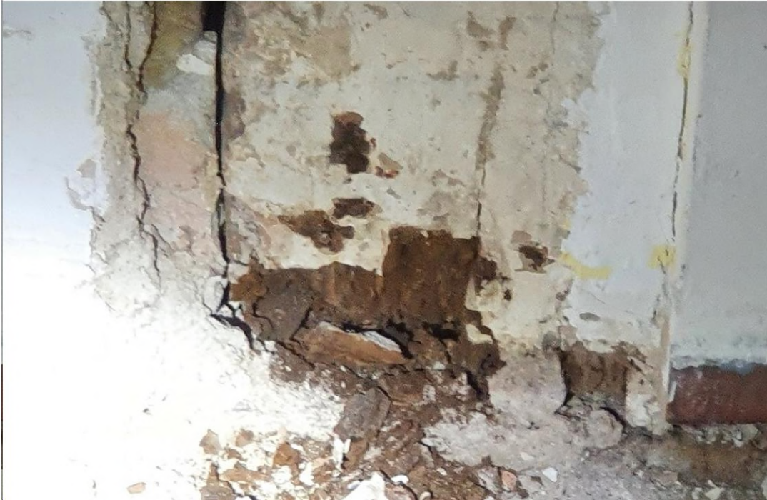
Foto 7- Blick auf zerstörten Fußpunkt Stütze
