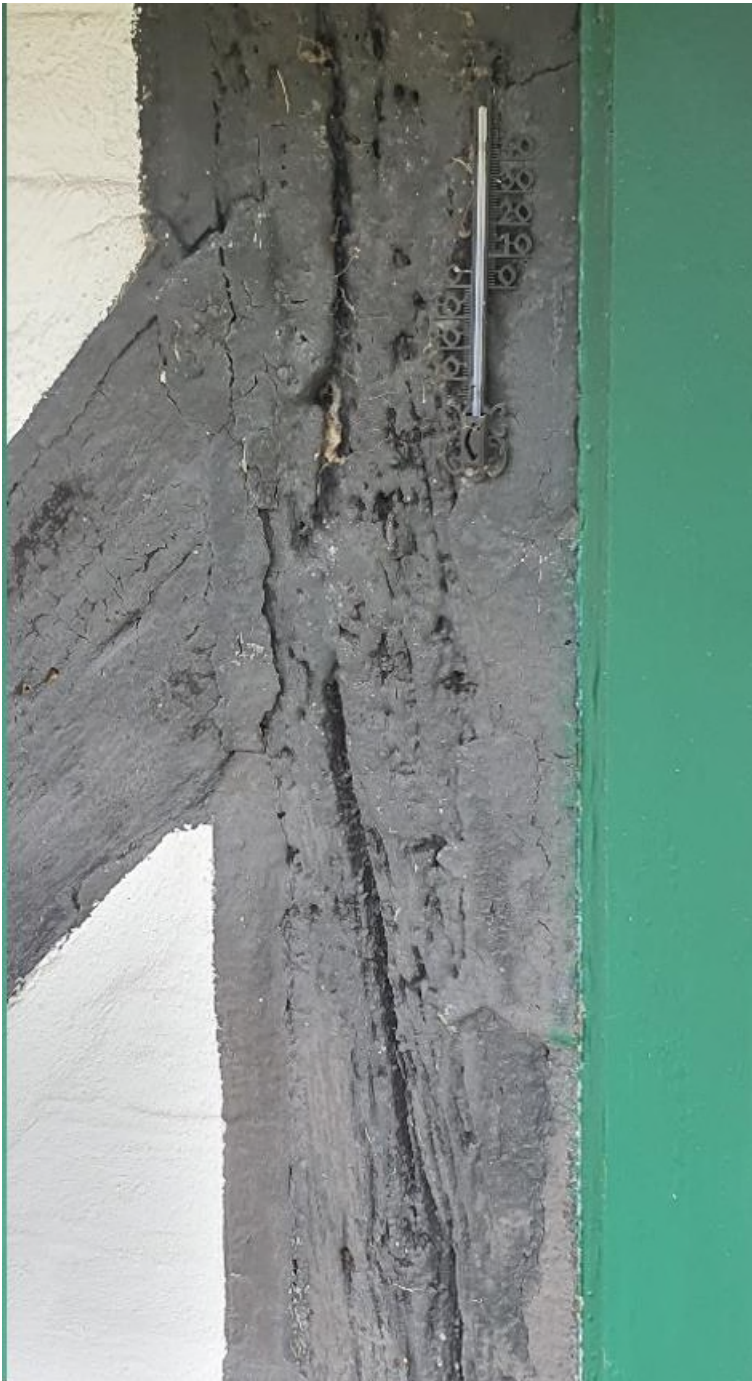
Foto 15- Zerstörtes Holz ( teilweise unter Anstrich )
