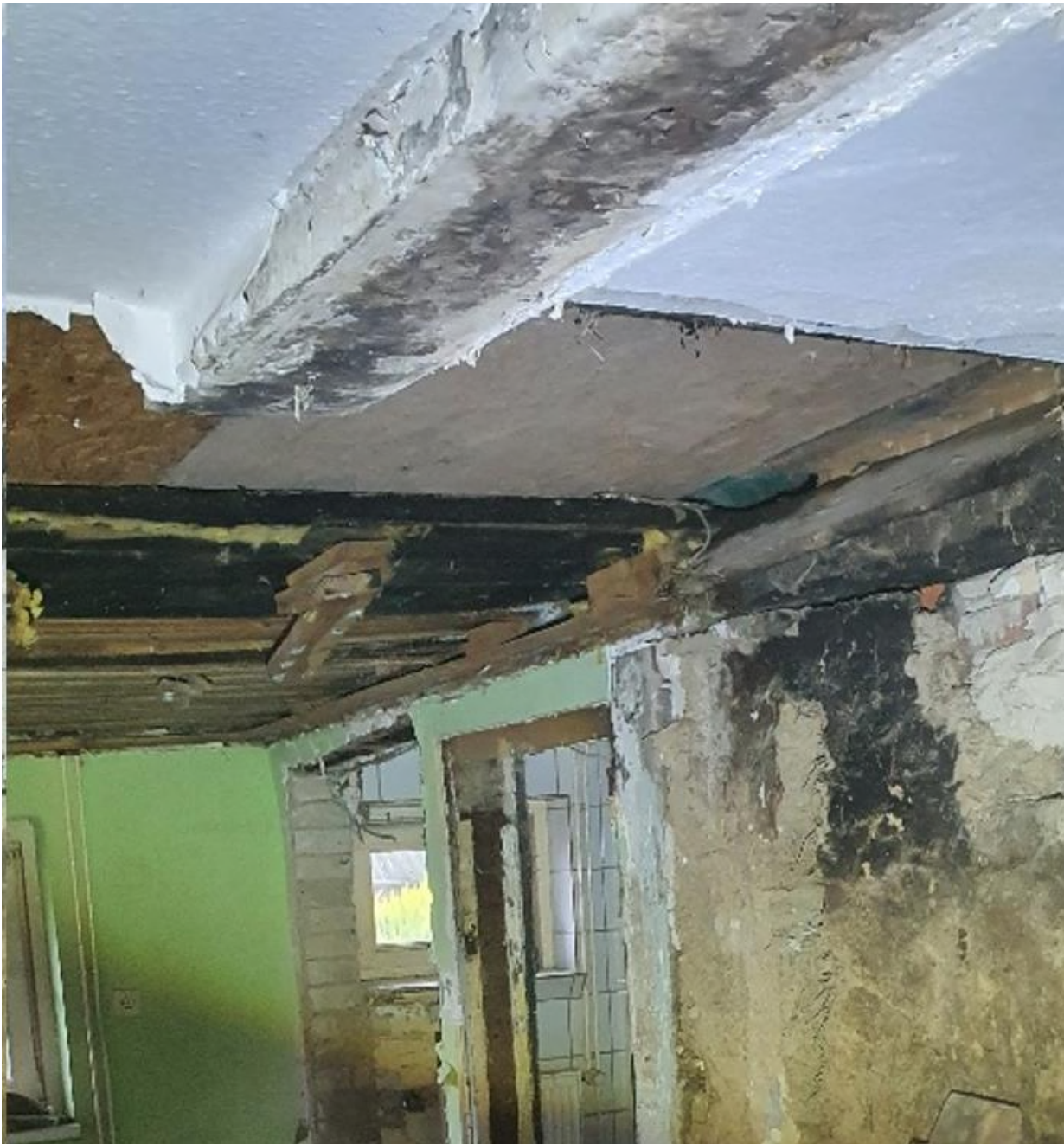
Foto 19 - ungeklärte Auflager Situation
