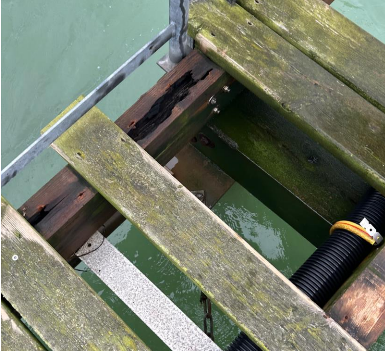
Abb. 3: Kopfsteg mit deutlichen Verwitterungserscheinungen am Längsbalken
