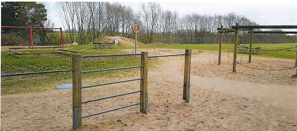
Abbildung 1: Spielplatz im Bestand, die Reckstangen und das Gerüst rechts im Bild sind marode und werden abgerissen
